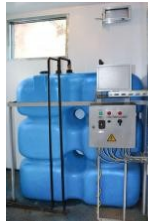
Топливная система и автоматика котла
