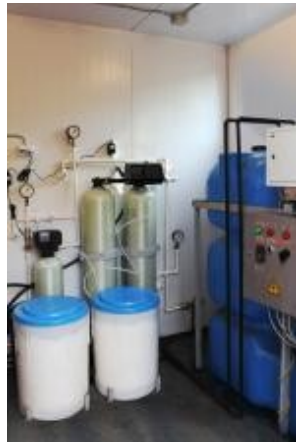
Водоподготовка, топливная система и автоматика котла
