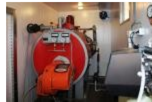
Общий вид котла и Кип котла в котельной
