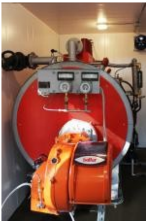
Общий вид котла и Кип котла в котельной
